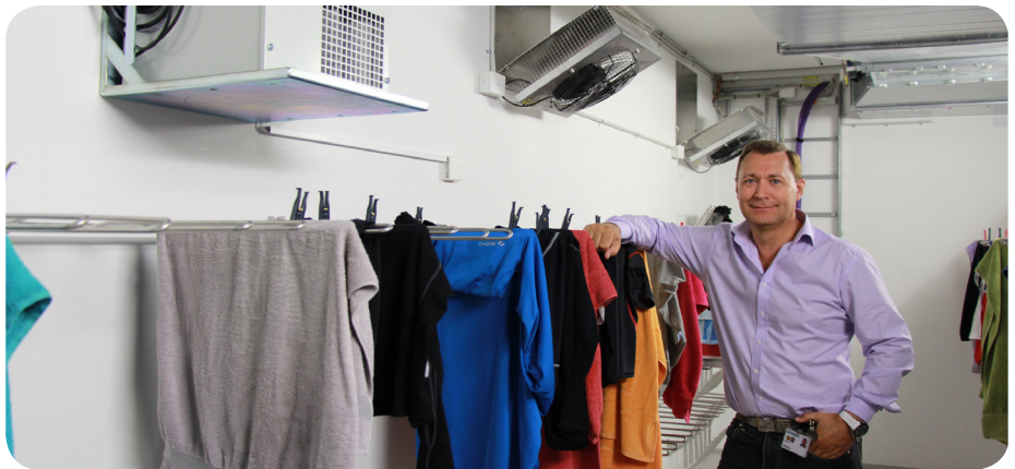
Michael Götz, Projektleder hos Siemens A/S i det nyindrettede personale-tørrerum
